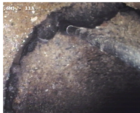
Brud på kloakrør
