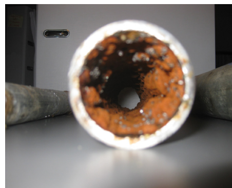
Eksempel på brugsvandsrør med aflæringer
