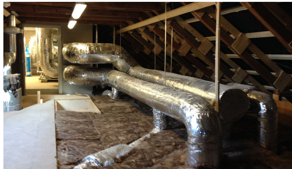
Eksempel på et decentralt vent.
